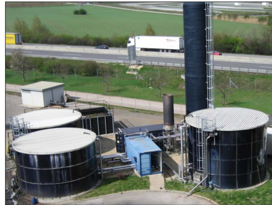
Flydende væske buffertanke (til venstre), overfladevandtank (til højre)
