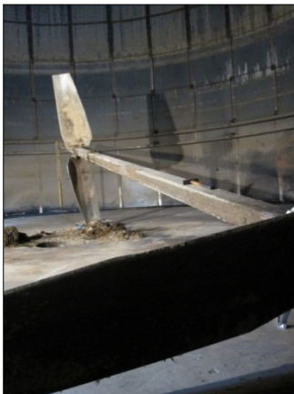
Den primære rådnetanks centralomrører
