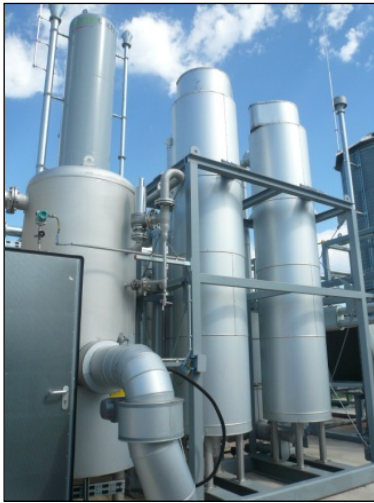
Rå biogas buffertank (forrest til venstre), x2 aktive kulfiltre (i midten til højre), biometan lagertank (bagerst til venstre)
