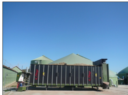
Automatiseret faststofs anlæg
